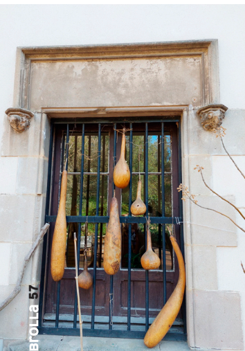
Detall d'un dels finestrals de la planta baixa.
